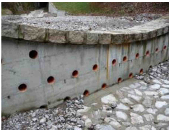
Figura 34: Vasca di decantazione, località Fortogna comune di Longarone.
