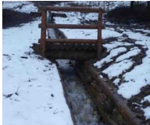
Figura 47: Canale località Bastiani di Puos d'Alpago a seguito di un'intensa precipitazione.
