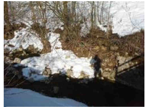
Figura 41: Località Vallenzai, comune di Mel, particolare dell'argine crollato.
