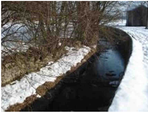
Figura 40: Ottavo caso analizzato, località Vallenzai, comune di Mel.
